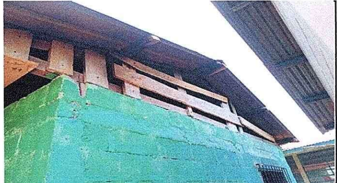
Foto 4: DETERIORO DE PAREDES EN LA COCINA
