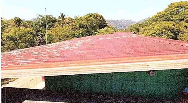
Foto1: DETERIORO DE LOS TECHOS, LAMINAS OXIDADO CON GOTERAS, CAPOTES OXIDADOS
