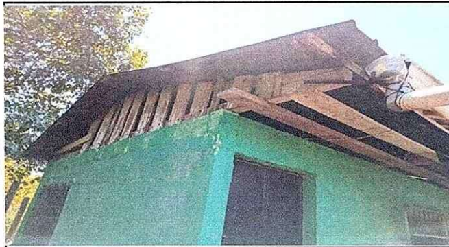
Foto 3: TECHO DE COCINA POR LAMINAS OXIDADAS Y GOTERAS. VIGAS APOLLILLADAS
