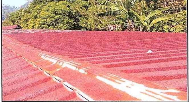
Foto 2: DETERIORO DE LOS TECHOS
